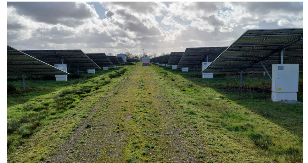
Technische installaties die goed beschermd zijn (bron: Eelerwoude)
