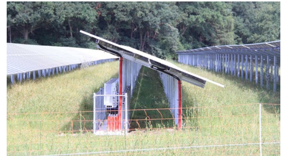
Technische installaties goed beschermd (bron: Eelerwoude)
