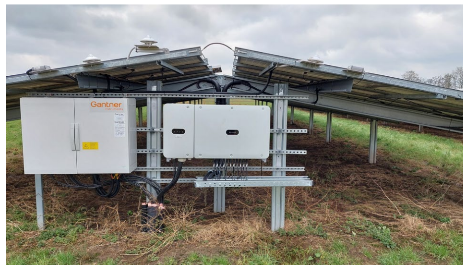
Technische installaties niet goed beschermd (bron: Eelerwoude)
