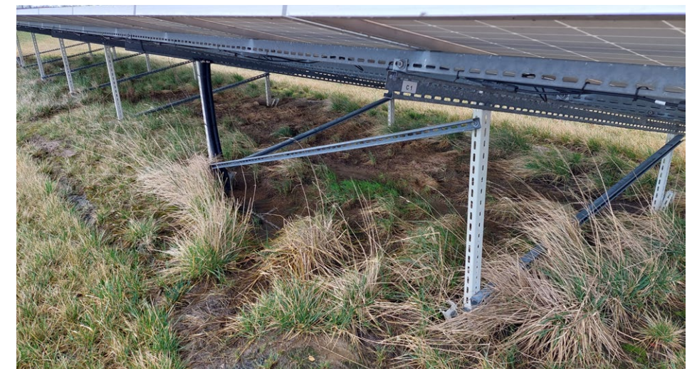
Ongeschikte onderconstructie (bron: Eelerwoude)
