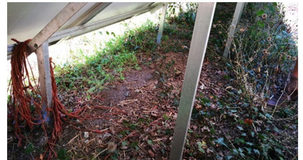
Te hoge klimplanten bij de installatie (bron: Eelerwoude)
