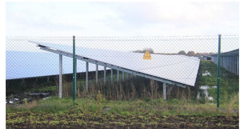
Gevolgen insporing en bodemverdichting (bron: Eelerwoude)
