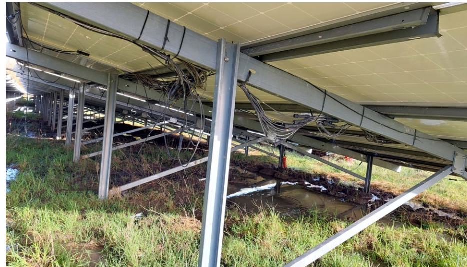
Slechte kabelafwerking (bron: Eelerwoude)
