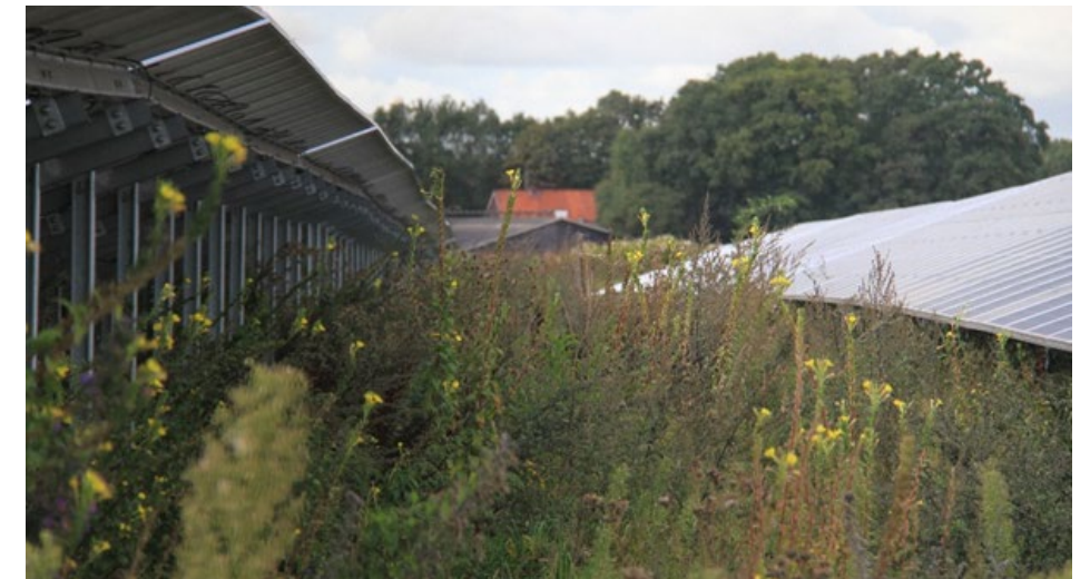
Onderhoud nodig. Vegetatie geeft schaduw op panelen (bron: Eelerwoude)
