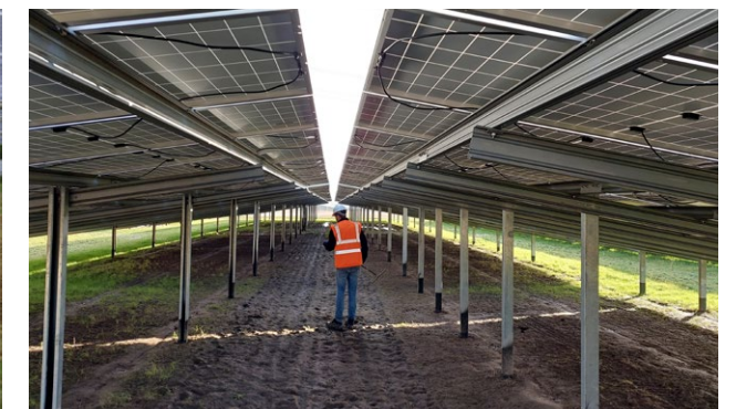
Tweezijdige opstelling waarbij de beheerder er onderdoor kan lopen (bron: Eelerwoude)
