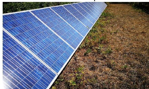
Panelen staan te dicht op de grond (bron: Eelerwoude)
